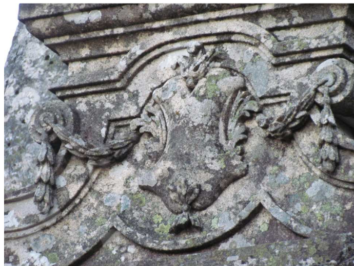
Foto 3 – Pedestal de estátua (antes do restauro): reparar no recorte nítido e homogéneo dos ornatos. Fonte: Foto do autor, tirada em 14/03 /2013
