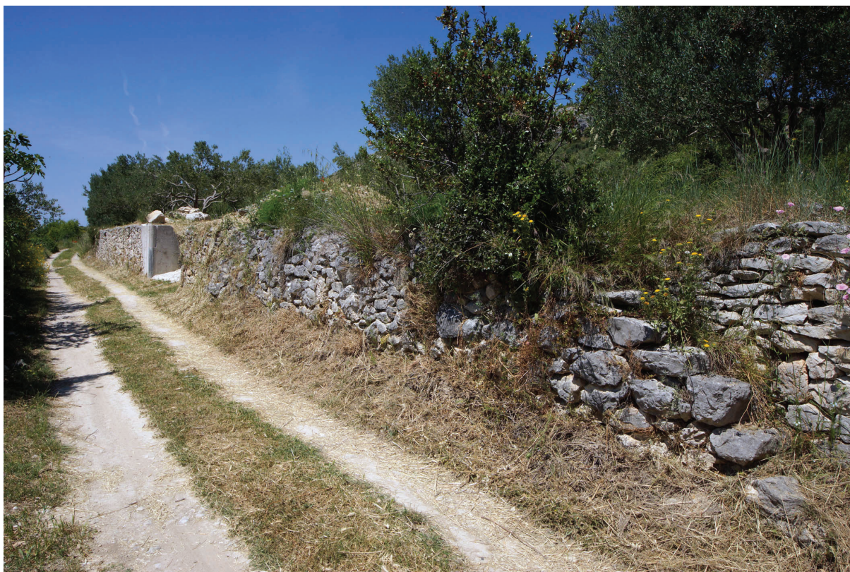
Sl. 2. Osnovna terasa uz staru cestu kroz Donje polje. U prvom je planu stepenište koje potječe iz vinogradarske prošlosti, a koje je služilo za onemogućavanje ulaza stoke, u pozadini se vidi probijena rampa za prilaz vozila s prikolicom masliniku (foto: J. Kale)
