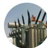
Servis i revitalizacija transformatora korisnička podrška dijagnostika i održavanje
