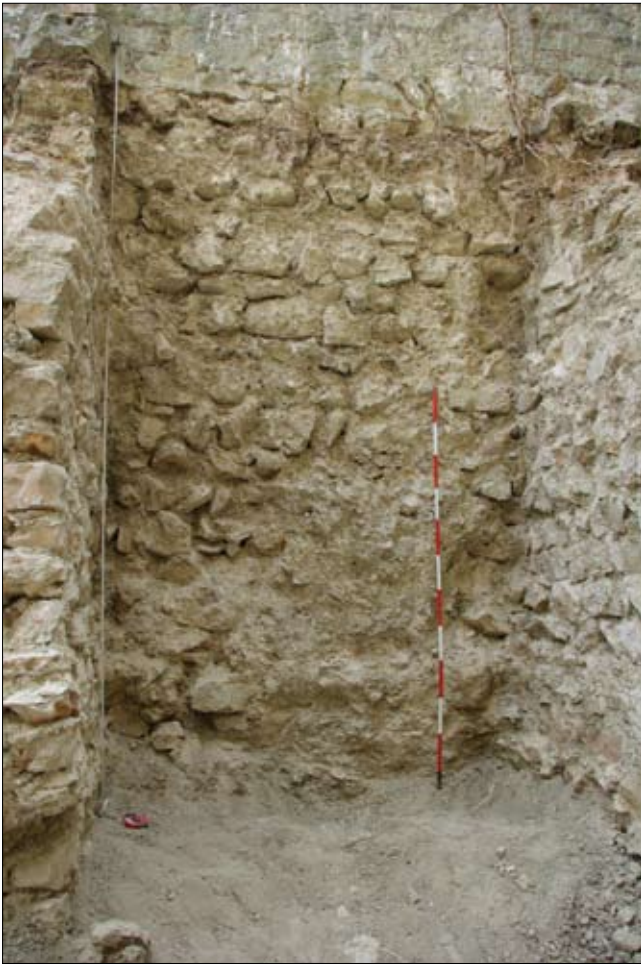
Sl. 12 Unutrašnje lice istočnog zida Barbakana Fig. 12 Inner face of the eastern wall of the Barbakan
