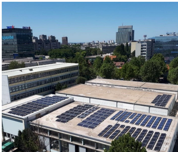
Slika 3. 80 kW solarna elektrana na krovu SGLab-a
