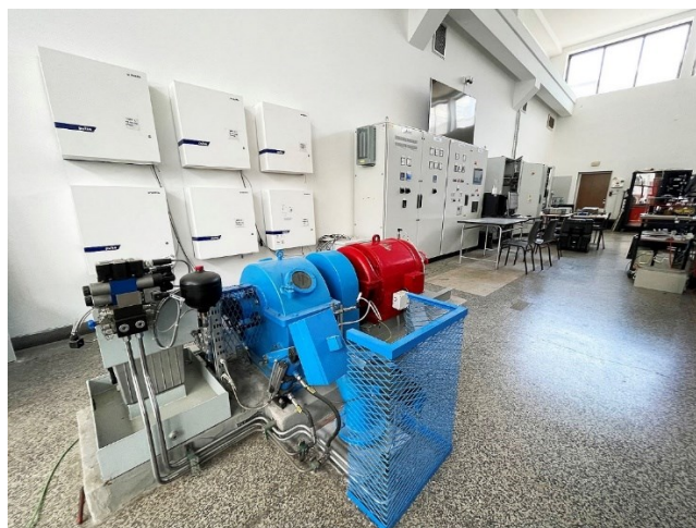
Slika 2. Varta Neo Pulse baterijski spremnici i hidroagregat s Pelton turbinom
