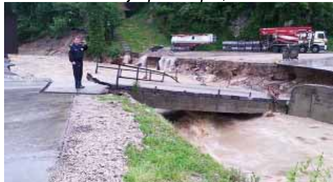
Slika 3. Oštećena putna infrastruktura u maju 2014.godine. Područje opštine Sapna, BiH
