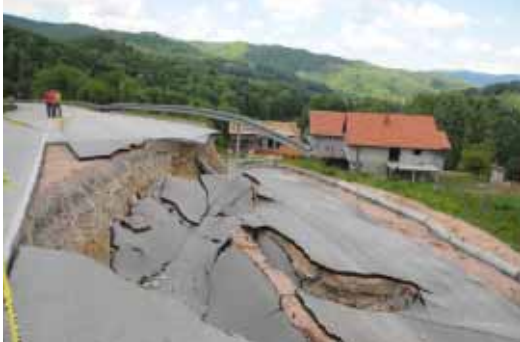
Slika 3. Oštećena putna infrastruktura u maju 2014.godine. Područje opštine Sapna, BiH
