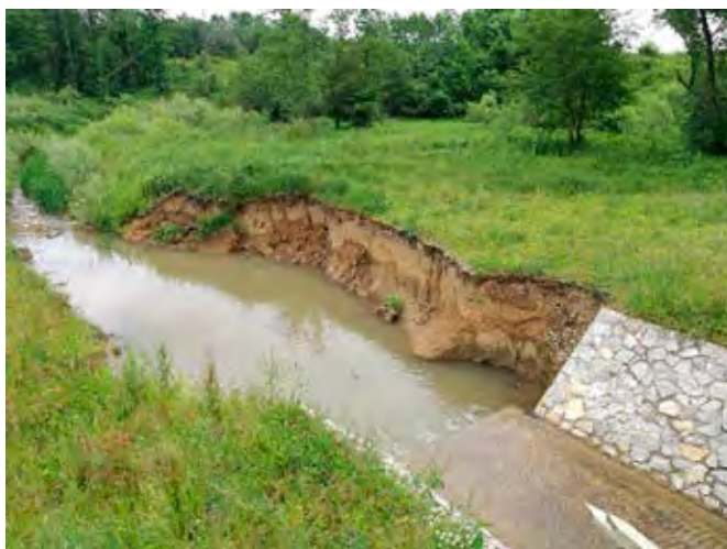
Slika 3. Pojačana erozija uzrokovana uzvodnim utvrđivanjem korita
