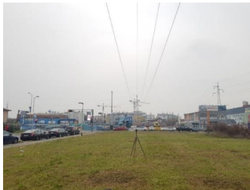
Figure 1. Actual 110 kV power line
