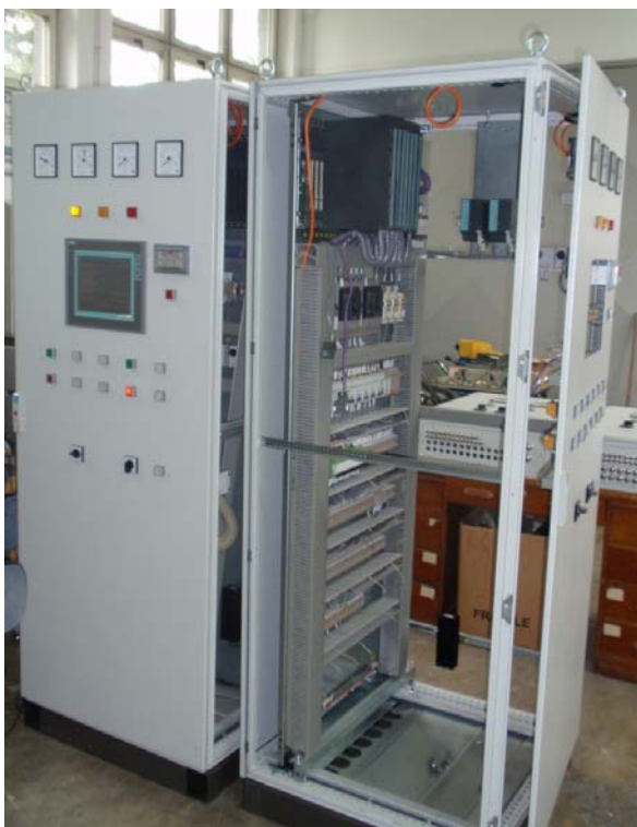
Slika 4. Ormari turbinske regulacije glavnog agregata (lijevo) i ABM (desno) u pripremi za tvornička ispitivanja; na stolu odostraga ormari pomoćnih pogona
