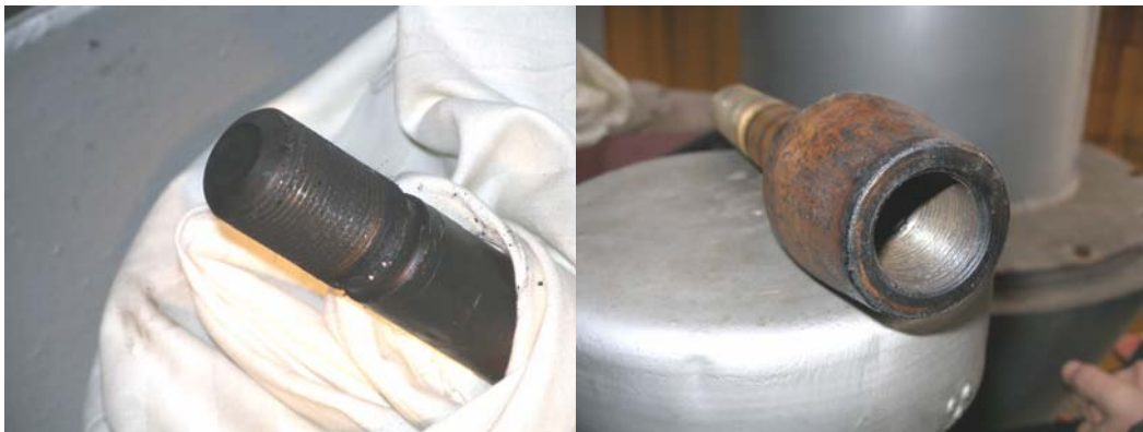
Slika 5. Tragovi pregrijavanja na svorniku i izvodu faze "B" VN namota
