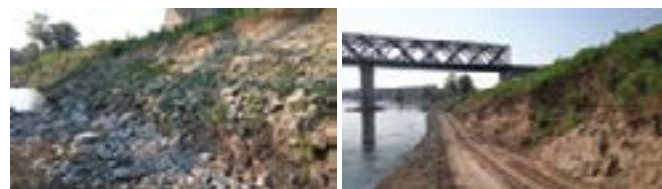
Slika 15. Urušena obaloutvrda (lijevo) u mostovskome profilu i nasip (desno) na lijevoj obali (pogled uzvodno).
