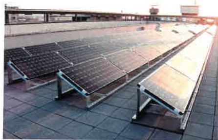
SLIKA 1. Fotonaponski paneli na ravnom krovu, izvor "Končar"
