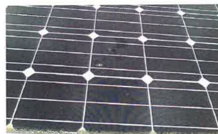
SLIKA 8. Površina panela prekrivena ptičjim izmetom
